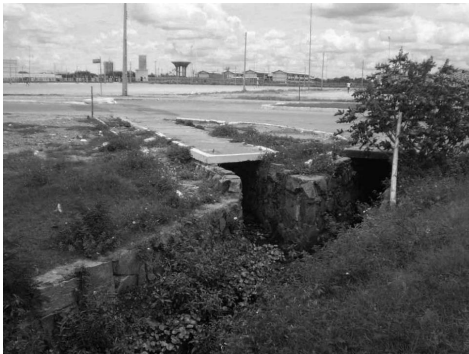
Figura 01: Drenagem pluvial e esgoto no canal Maria Auxiliadora
