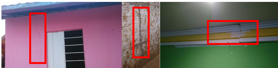
Figura 07: Casas rachadas por conta da detonação da rocha na comunidade da Vila Renascer em Petrolina, Pernambuco Nordeste do Brasil.
