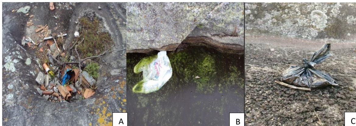
Figura 7: Presença de resíduos sólidos nos reservatórios.
