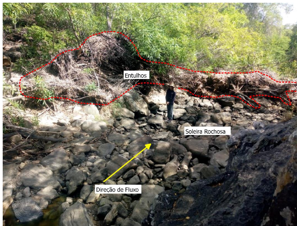
Figura 14: Acúmulo de entulho delimitado pela linha tracejada em vermelho e soleira rochosa em blocos.
