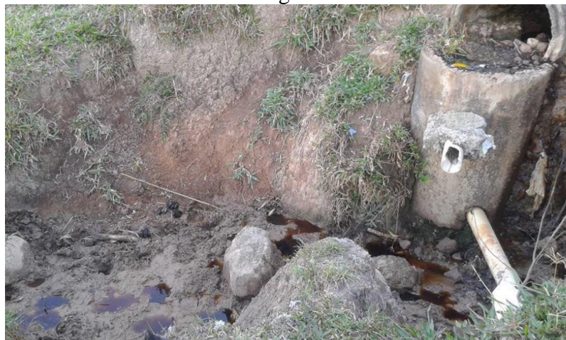
Figura 2 - Extravasamento de lixiviado e sistema de drenagem deficiente no lixão municipal de Lages-SC.
