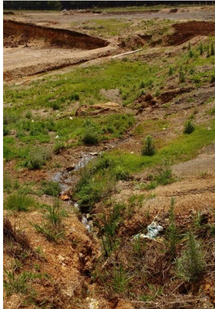
Figura 8 - Afloramento de lixiviado nos taludes.
