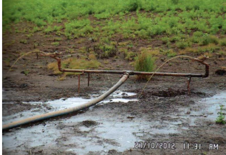
Figura 4 - Lançamento de efluente não tratado em solo descoberto.
