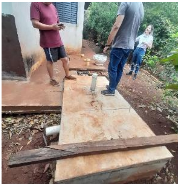
Fig. 3C- Condições no suspiro do tanque séptico.
